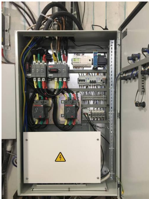
ООО «ЛЕСТА» (World of Tanks), ШАВР для серверной
