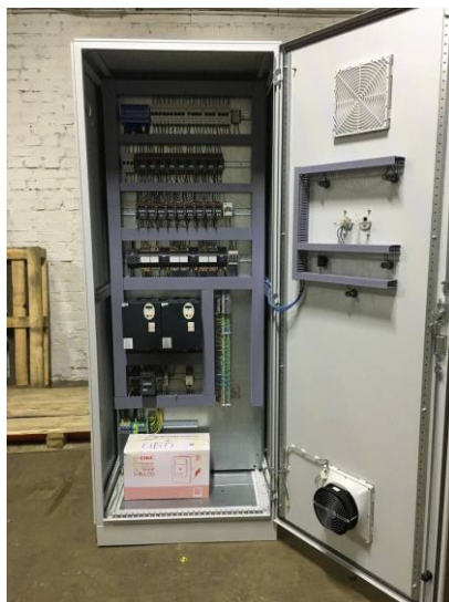
ООО «Аэрком», ШУ очистными сооружениями, февраль/март 2021 г.
