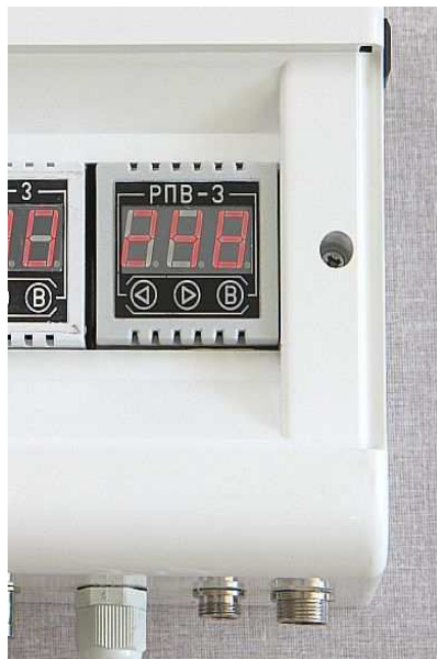
Фото 4. Модуль РПВ-3 и розетка для подключения ТЭНов
