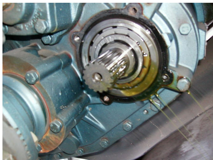
Coperchio rimosso / Cover removed
