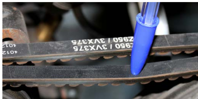
Контроль натяжения приводного ремня
