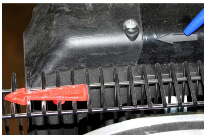
Контроль направления вращения
