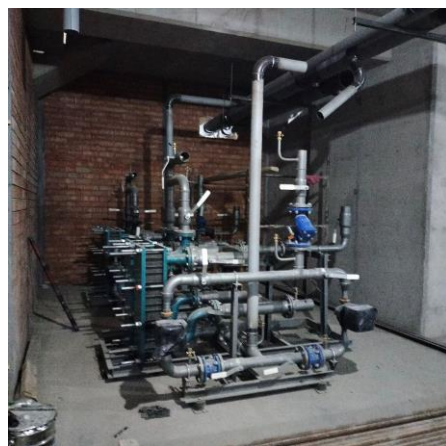
Насосная станция Узбекистан, г. Ташкент ЖК U-Tower
