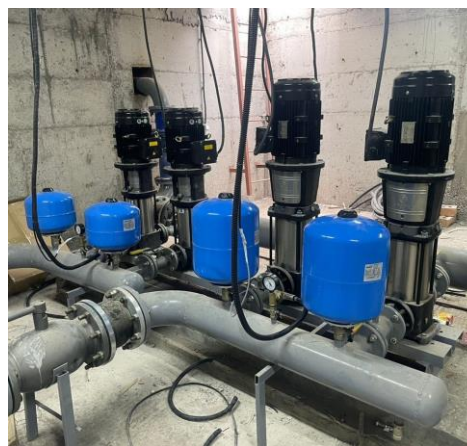
Насосная станция Кыргызстан, г. Бишкек ЖК Флоренция
