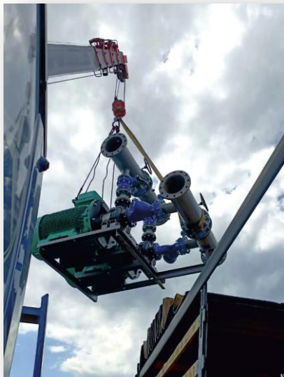
Насосная станция Узбекистан, г. Ташкент
