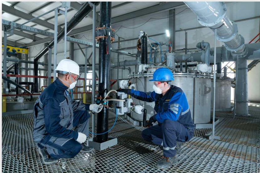
Оборудование для АО «НАК «Казатомпром»
