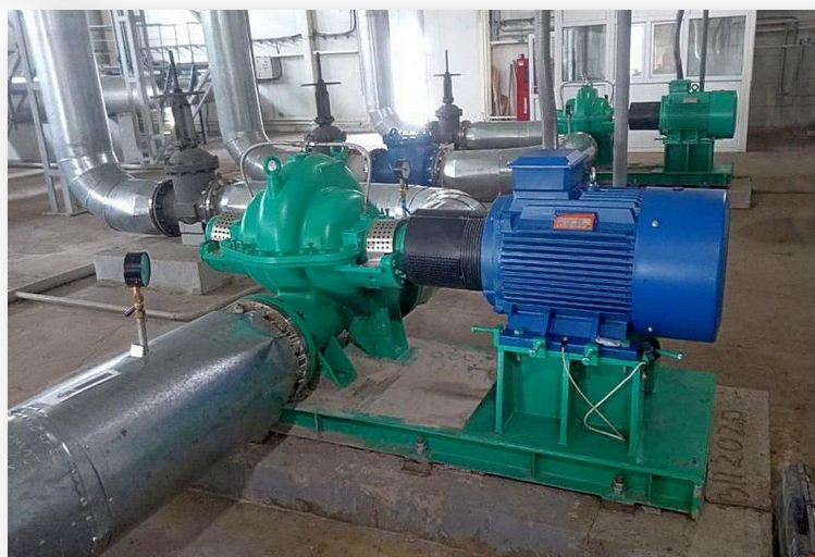
Насосные станции для ТОО «Алматинские тепловые сети»
